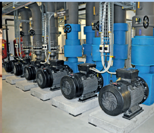
Installation de pompes de refroidissement
