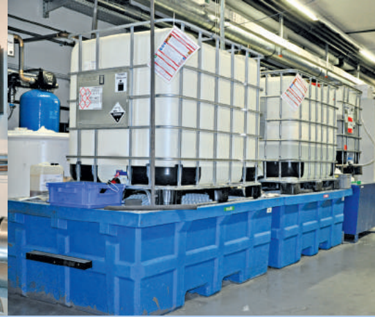
Traitement de l'eau
