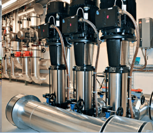
Installation de pompage pour chauffage à distance
