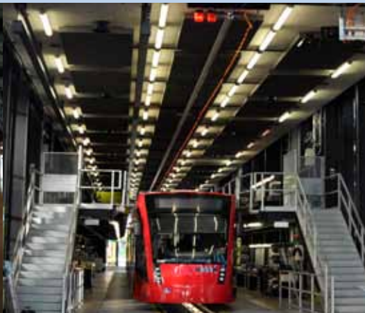
Luce di emergenza nel deposito dei tram
