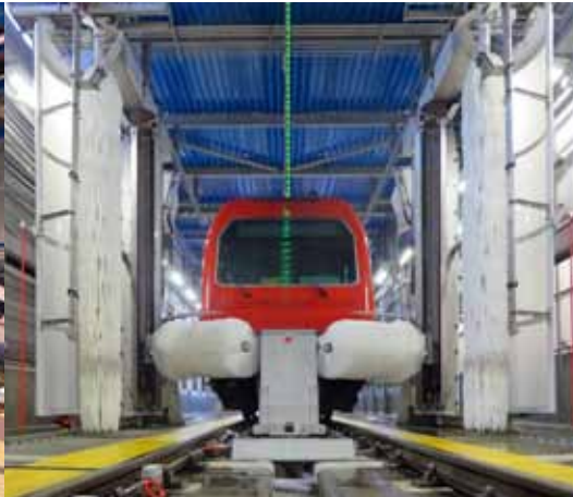
Installation de nettoyage de trains
